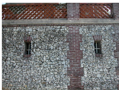
Détail du mur de soutènement de la maison dite Villa Sainte-Cécile. Phot. Elisabeth Justome IVR22_20048001544NUCA
