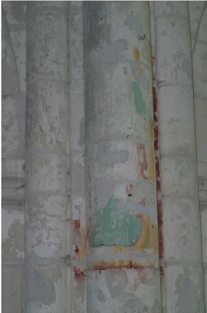
Restes de polychromie sur un pilier de la nef.
