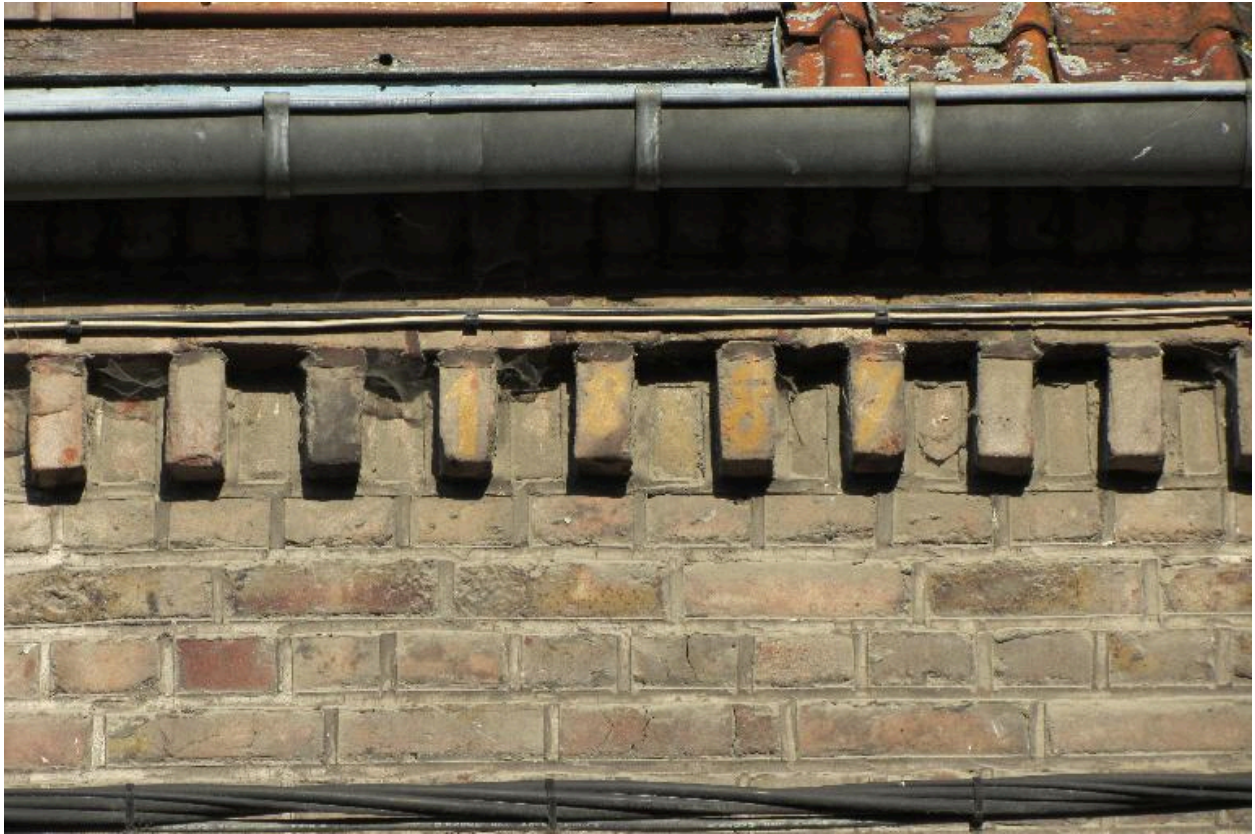
Date de 1887 peinte sur les modillons en brique de corniche d'un logement de la cité ouvrière.
