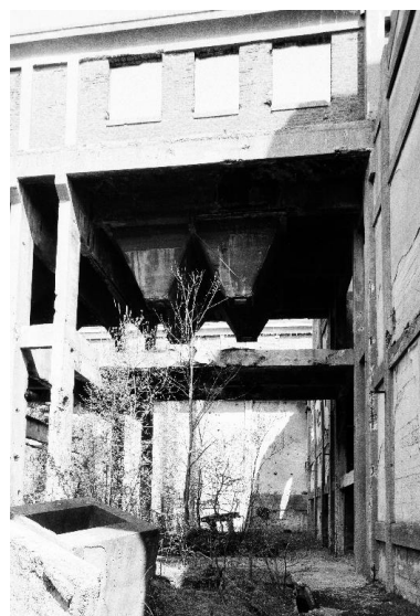
Atelier de fabrication, premier étage, goulottes. Phot. Benoît Dufournier IVR22_19908001541Z
