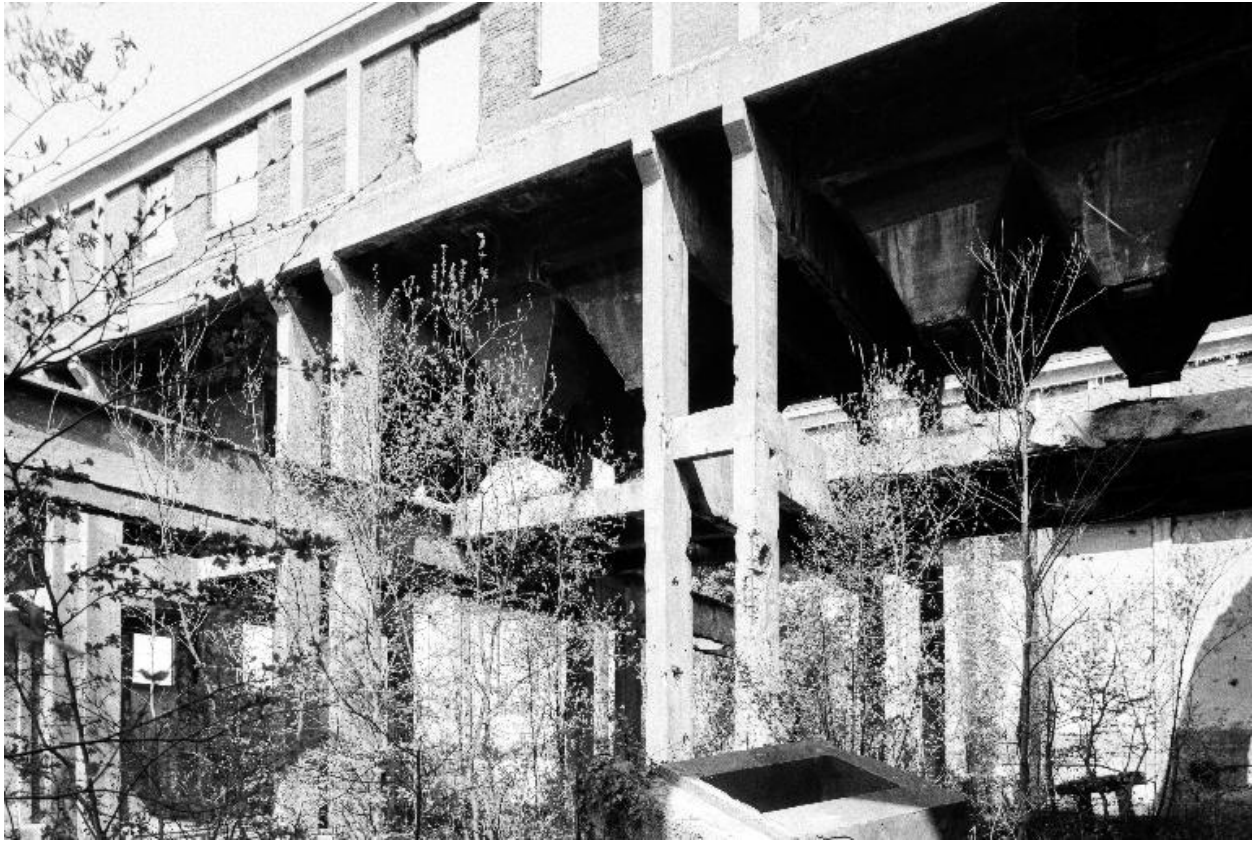
Atelier de fabrication, premier étage, goulottes.
