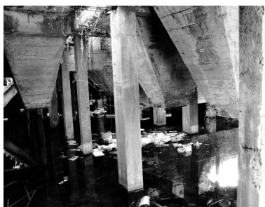
Atelier, salle des goulottes, détail. Phot. Benoît Dufournier IVR22_19908001534Z
