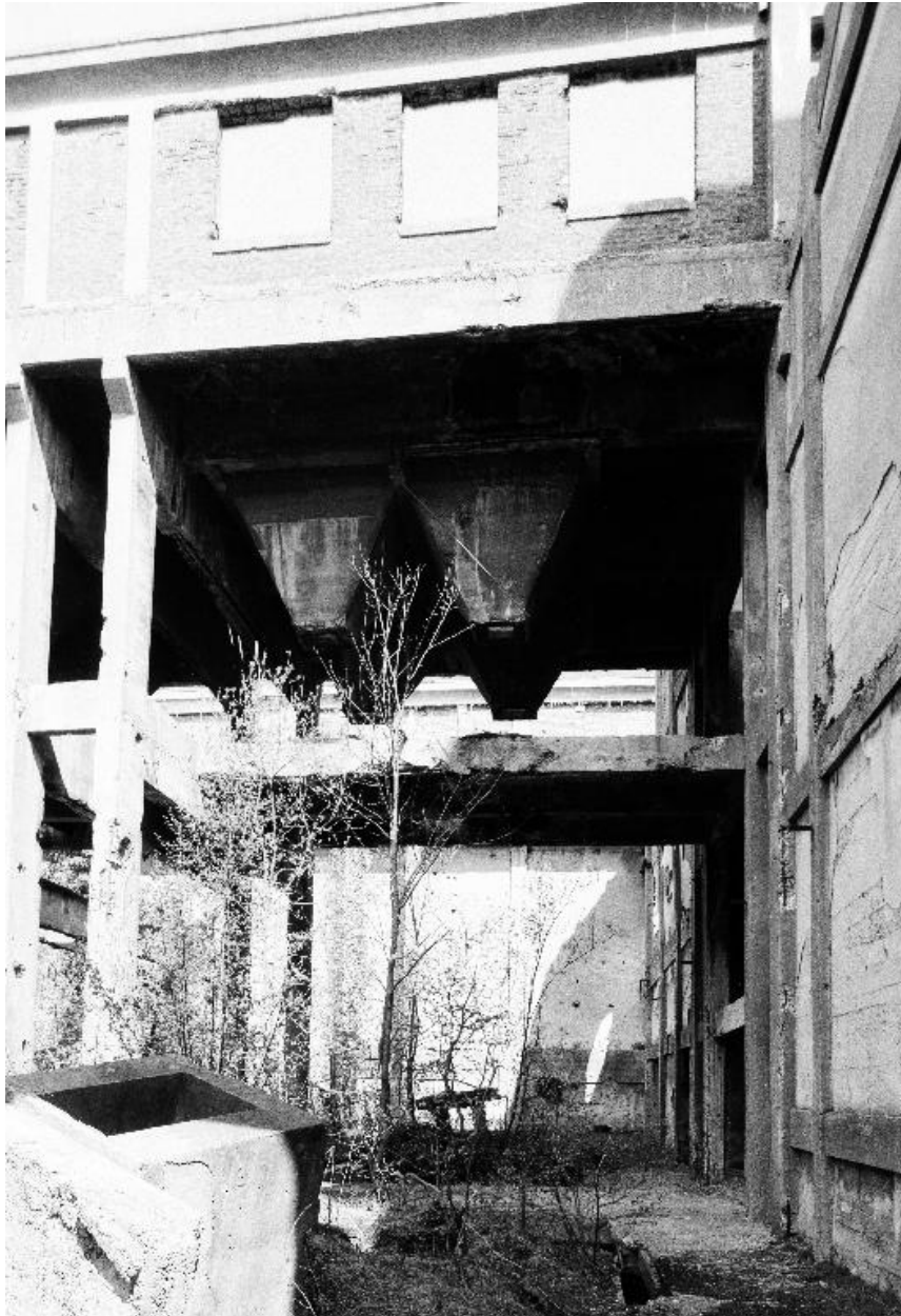
Atelier de fabrication, premier étage, goulottes.
