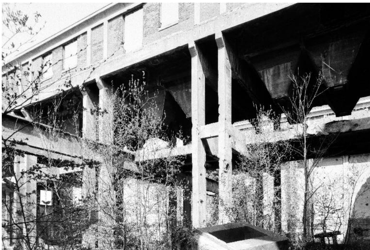
Atelier de fabrication, premier étage, goulottes.
