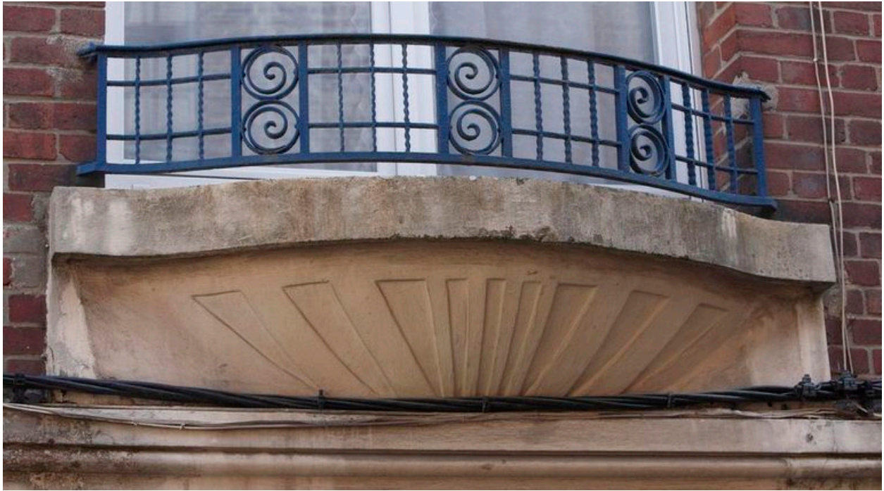
Encorbellement à stries géométriques et garde-corps aux motifs à spirales, façade rue Saint-Aubert.
