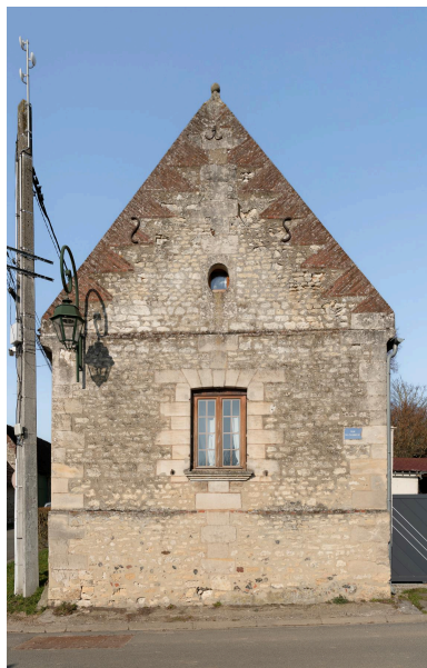
Mur-pignon en pierre, n°16 de la rue de Clermont, vue prise depuis le sud. Phot. Marc Kérignard IVR32_20236000197NUCA
