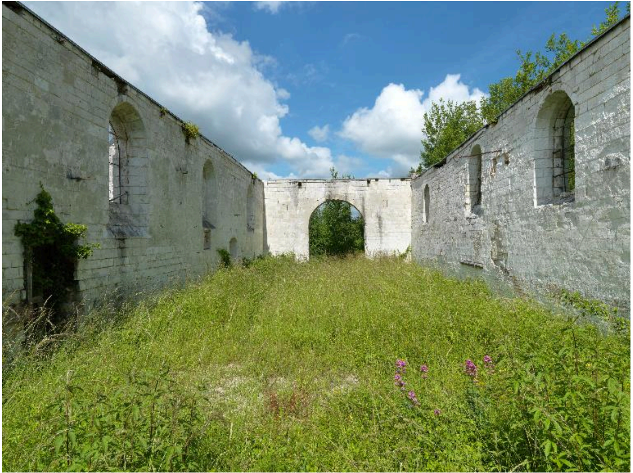
Vue intérieure de l'ancienne église incendiée en 1991.
