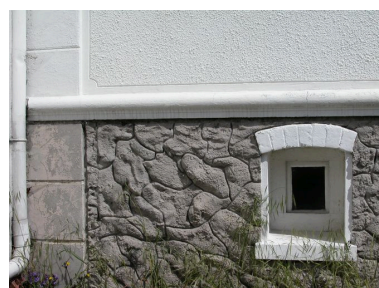
Détail du traitement de la base du mur, en enduit imitant des moellons de pierres. Phot. Elisabeth Justome IVR22_20058002848NUCA
