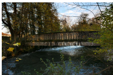
Pont sur une dérivation de rivière, reliant les deux parties de l'ancienne usine. Phot. Thierry Lefébure IVR22_20138000508NUC2A
