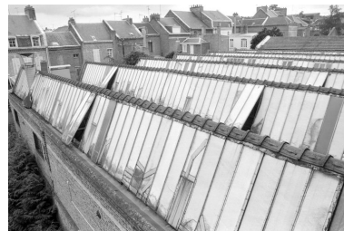
Ateliers de fabrication. Phot. Benoît Dufournier IVR22_19918000231Z
