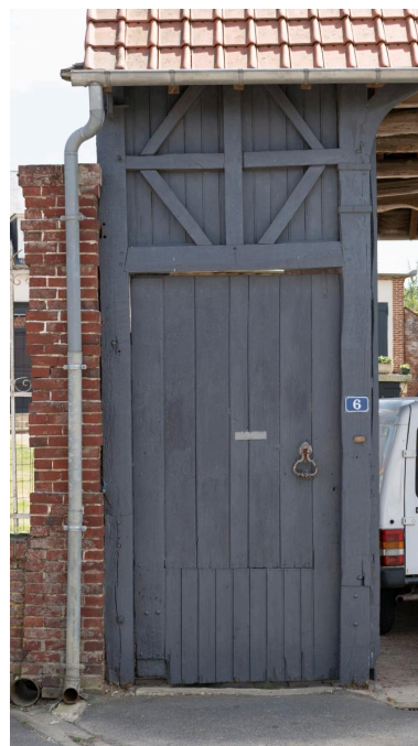
Porte piétonne avec imposte ajourée, n°6 rue Neuve, vue depuis le nord. Phot. Marc Kérignard IVR32_20226000703NUCA
