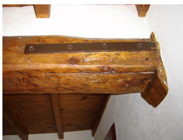
Système de fixation des poutres sur les murs gouttereaux. Phot. Inès Guérin IVR22_20068005852NUCA
