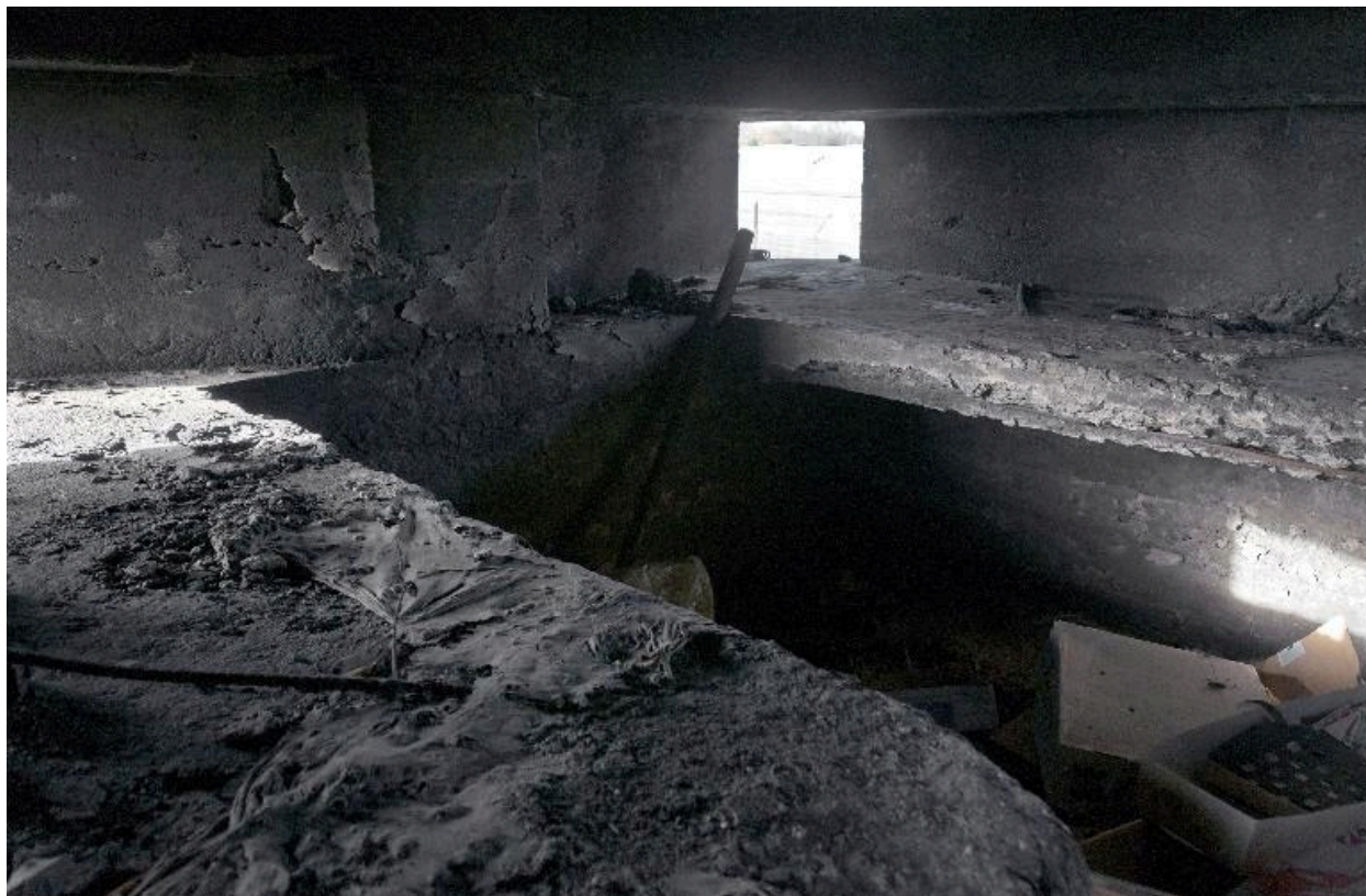
Vue intérieure des banquettes de tir nord et sud. Embrasure de tir nord-ouest
