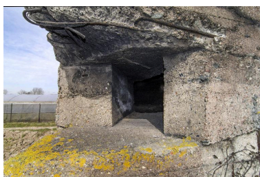
Embrasure de tir située sur l'angle sud-ouest de l'édifice. Phot. Jean-Marc Ramette IVR32_20165901482NUCA
