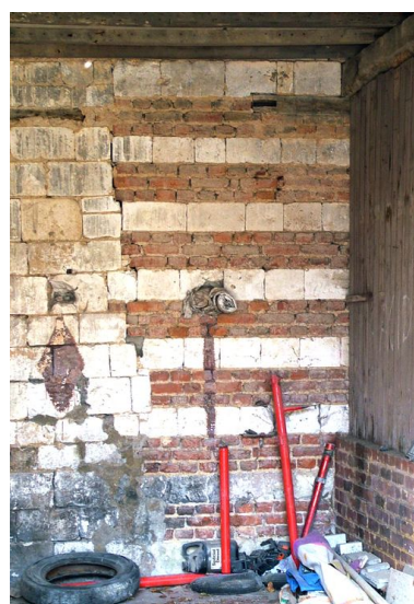
Détail de l'appareil mixte du mur arrière des communs. Phot. Frédéric Fournis IVR22_20108001144NUCA
