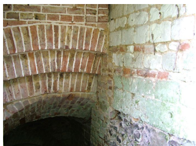
Voûte à ressaut de l'escalier d'accès au sous-sol de la maison du jardinier.
