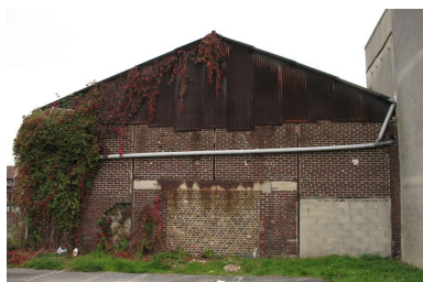
Etat du mur pignon sud-ouest en brique. Phot. Clarisse Lorieux IVR22_20066005160NUCA
