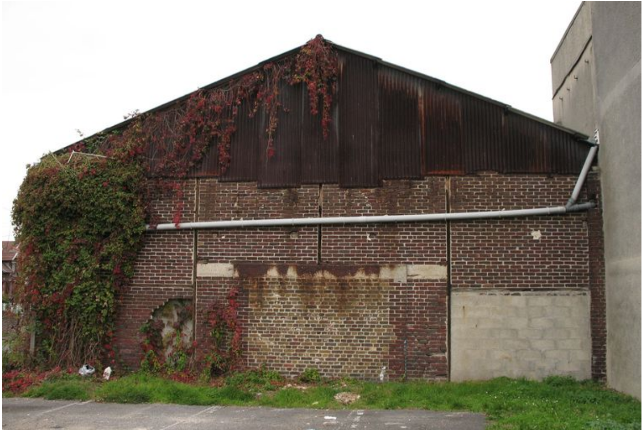
Etat du mur pignon sud-ouest en brique.
