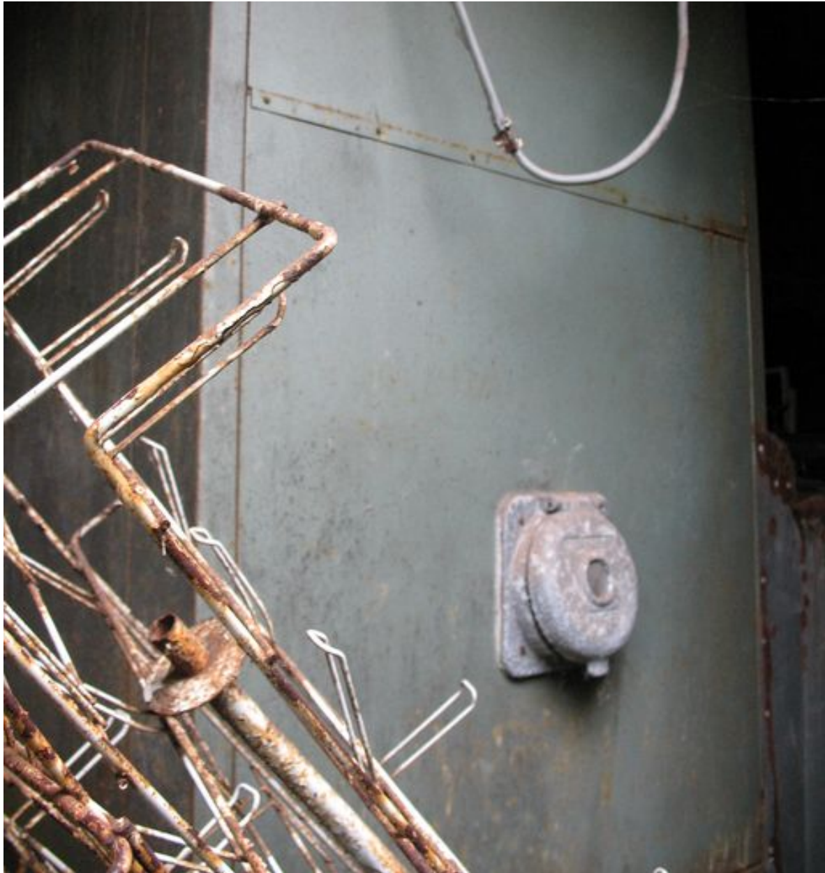
Le générateur électrique.
