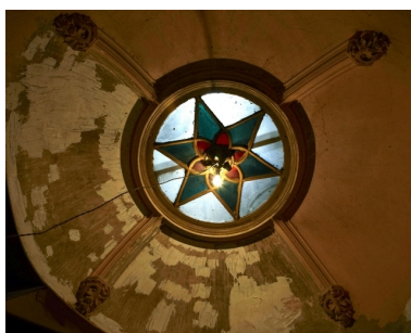
Détail de la verrière surmontant l'escalier situé dans le bâtiment abritant les pièces de réception. Phot. Pierre Thibaut IVR31_20095903305NUCA
