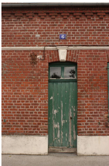
6 rue Saint-Pierre, vue de détail sur la porte du logement. Phot. Thierry Lefébure IVR22_20038001012NUCA
