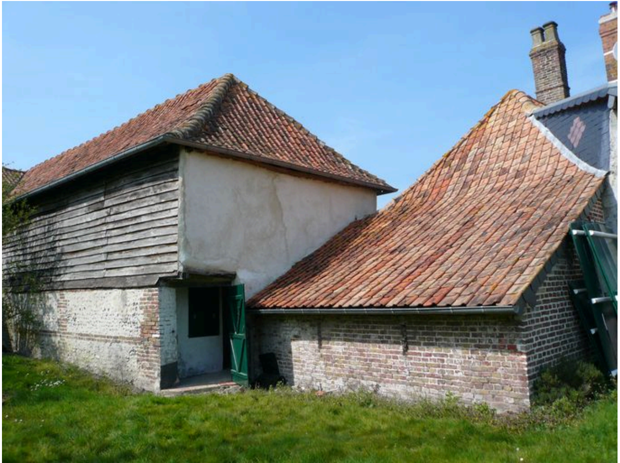
Vue postérieure de la grange et de l'angle sud-ouest du logis, avec passage couvert de la cour vers la pâture.
