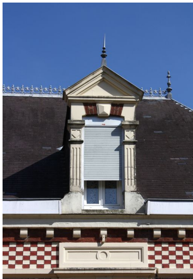
Détail de la corniche en damier et de la lucarne passante. Phot. Bertrand Fournier IVR22_20098005019NUCA
