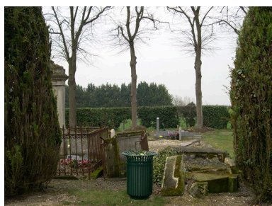
Partie ancienne du cimetière. Allée principale (rive sud). Tombeaux en mauvais état. Phot. Isabelle Barbedor IVR22_20058010227NUCA
