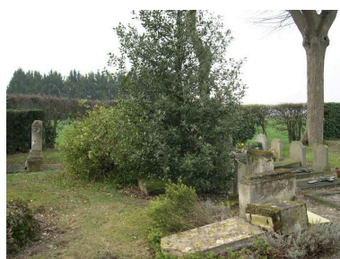
Partie ancienne du cimetière. Allée principale (rive sud). Tombeaux en mauvais état. Phot. Isabelle Barbedor IVR22_20058010225NUCA
