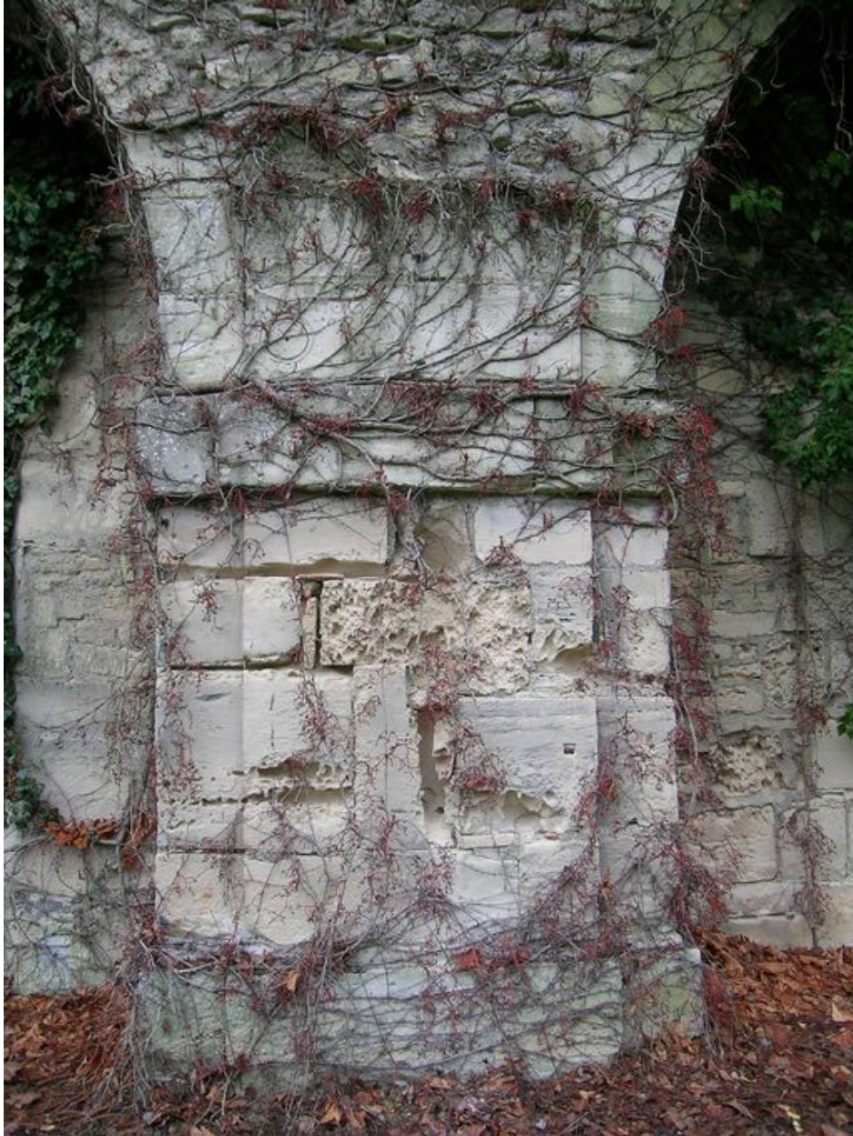
Détail des soubassements endommagés.
