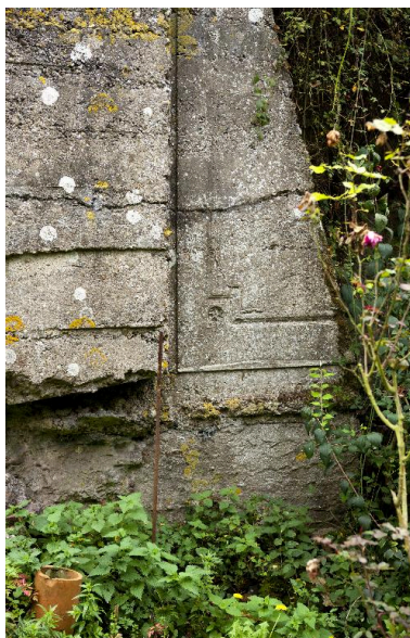
Détail du contrefort est. Empreintes d'une porte Phot. Jean-Marc Ramette IVR31_20145904206NUCA
