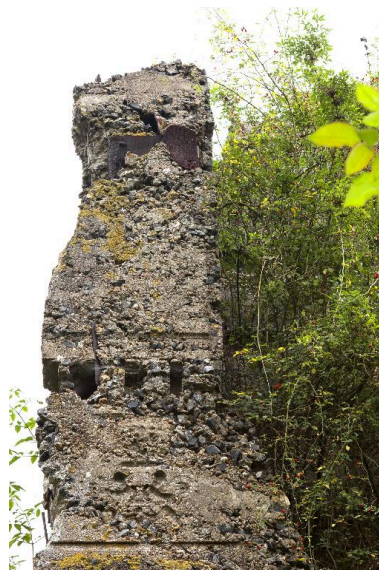
Détail du contrefort est où apparaissent des fragments de blindage (en haut) ainsi que les empreintes des bois de coffrage moulurés utilisés : une porte (à droite), des angelots (en bas) Phot. Jean-Marc Ramette IVR31_20145904207NUCA
