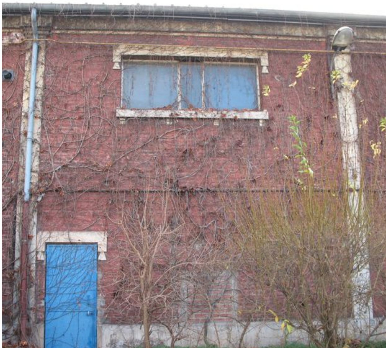
Détail de l'une des travées du mur nord de la salle des fêtes.
