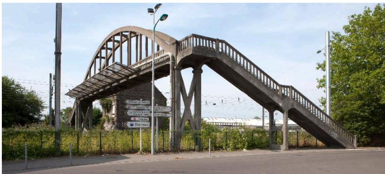
Passerelle piétonne située face à la rue Marillon permettant d'enjamber le chemin de fer.
