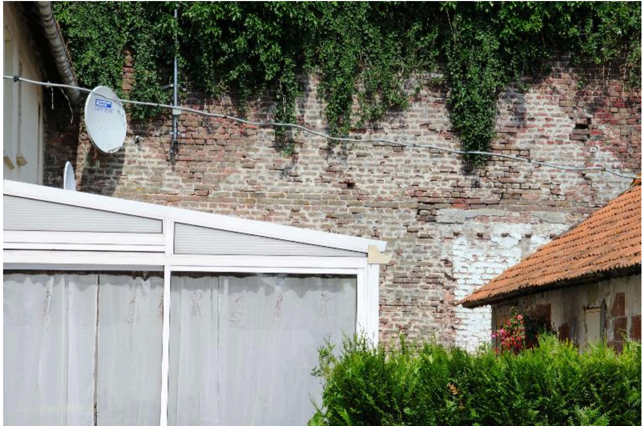
Traces d'un ancienne toiture en shed sur le mur en brique en fond de parcelle.
