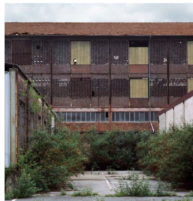
Détail de l'atelier d'embarillage et de sa façade à claire-voie. Phot. Thierry Lefébure IVR22_20106000202XA
