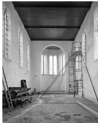
Vue intérieure (en cours de restauration), depuis l'entrée vers le chœur. Phot. Thierry Lefébure IVR22_19910201999V
