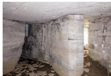
Salle est avec, à gauche, le mur de refend endommagé et, à droite, la sortie en chicane Phot. Pierre Thibaut IVR32_20165901057NUCA
