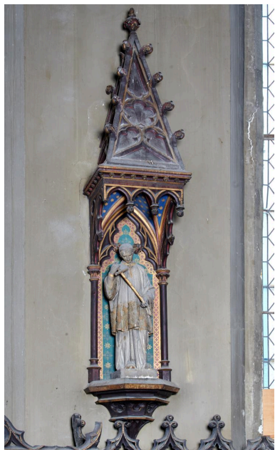
Vue générale d'une console avec son dais : type 1. Phot. Pierre Thibaut IVR32_20225900327NUCA
