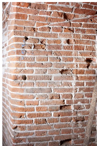
Niveau principal (R+1). Vue générale de gravures réalisées dans la briques d'un intrados d'une
