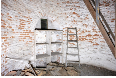
Chemin de ronde. Salle circulaire interne. Autre accès sous voûte d'ogive (accès bouché) avec casier à pigeons. Phot. Delphine Volto-Jourdan IVR22_20225900155NUCA
