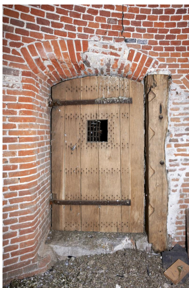
Niveau principal (R+1). Porte d'accès. Vue depuis l'intérieur. Porte à guichet. Poutre en réemploi dans un des piedroits. Phot. Delphine Volto-Jourdan IVR22_20225900135NUCA
