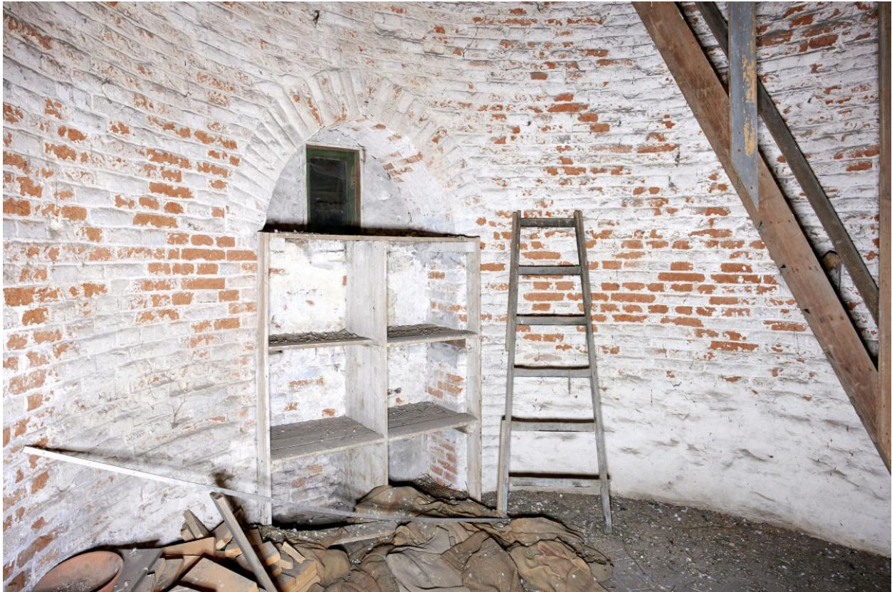
Chemin de ronde. Salle circulaire interne. Autre accès sous voûte d'ogive (accès bouché) avec casier à pigeons.
