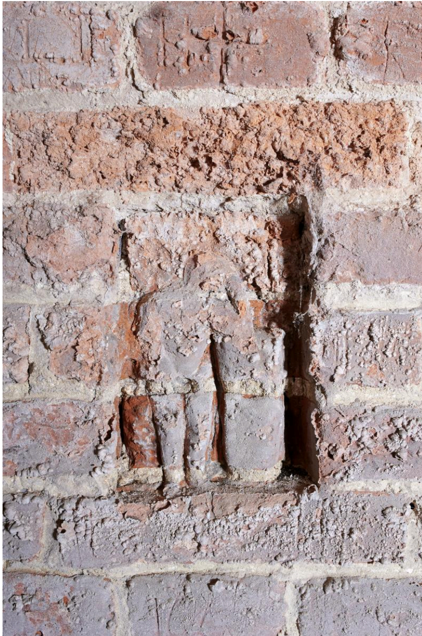
Niveau inférieur. Intrados de la niche de tir nord-ouest. Détail de la sculpture réalisée dans la brique.
