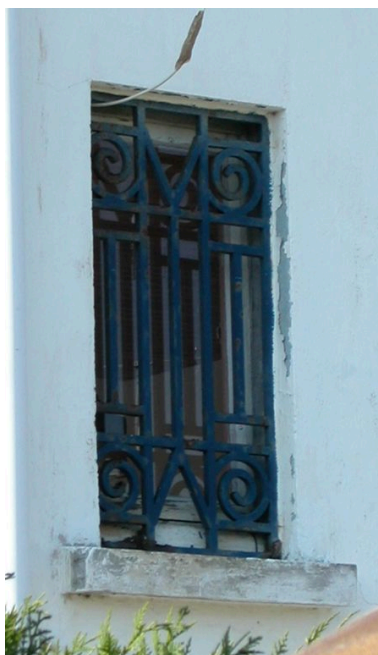
Détail d'une grille protégeant une baie de la façade latérale droite. Phot. Elisabeth Justome IVR22_20058002797NUCA
