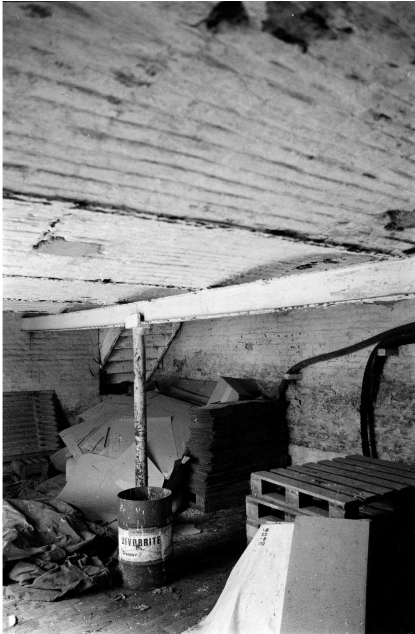
Sous-sol de la brasserie. Support de cuve de fermentation.
