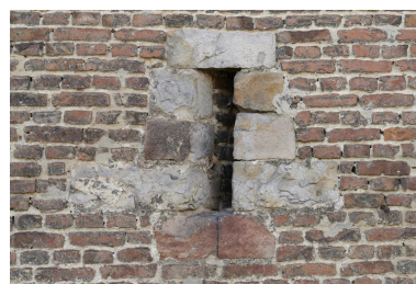
Détail d'une ouverture de ventilation des stabulations (étables). Vue prise depuis la façade du bâtiment. Phot. Pierre Thibaut IVR32_20236200055NUCA
