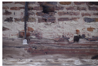
Détail du chronographe "1725", situé sur sous le passage couvert de la tour porche (vers l'intérieur). Phot. Pierre Thibaut IVR32_20236200058NUCA
