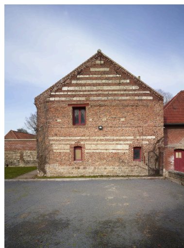
Mur pignon du bâtiment sud-ouest traité partiellement en rouges barres. Présence d'un linteau métallique. Phot. Pierre Thibaut IVR32_20236200066NUCA
