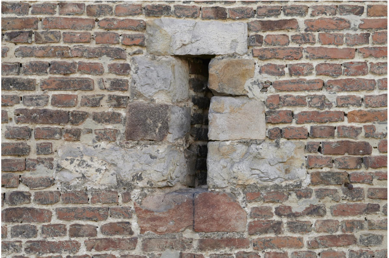
Détail d'une ouverture de ventilation des stabulations (étables). Vue prise depuis la façade du bâtiment.
