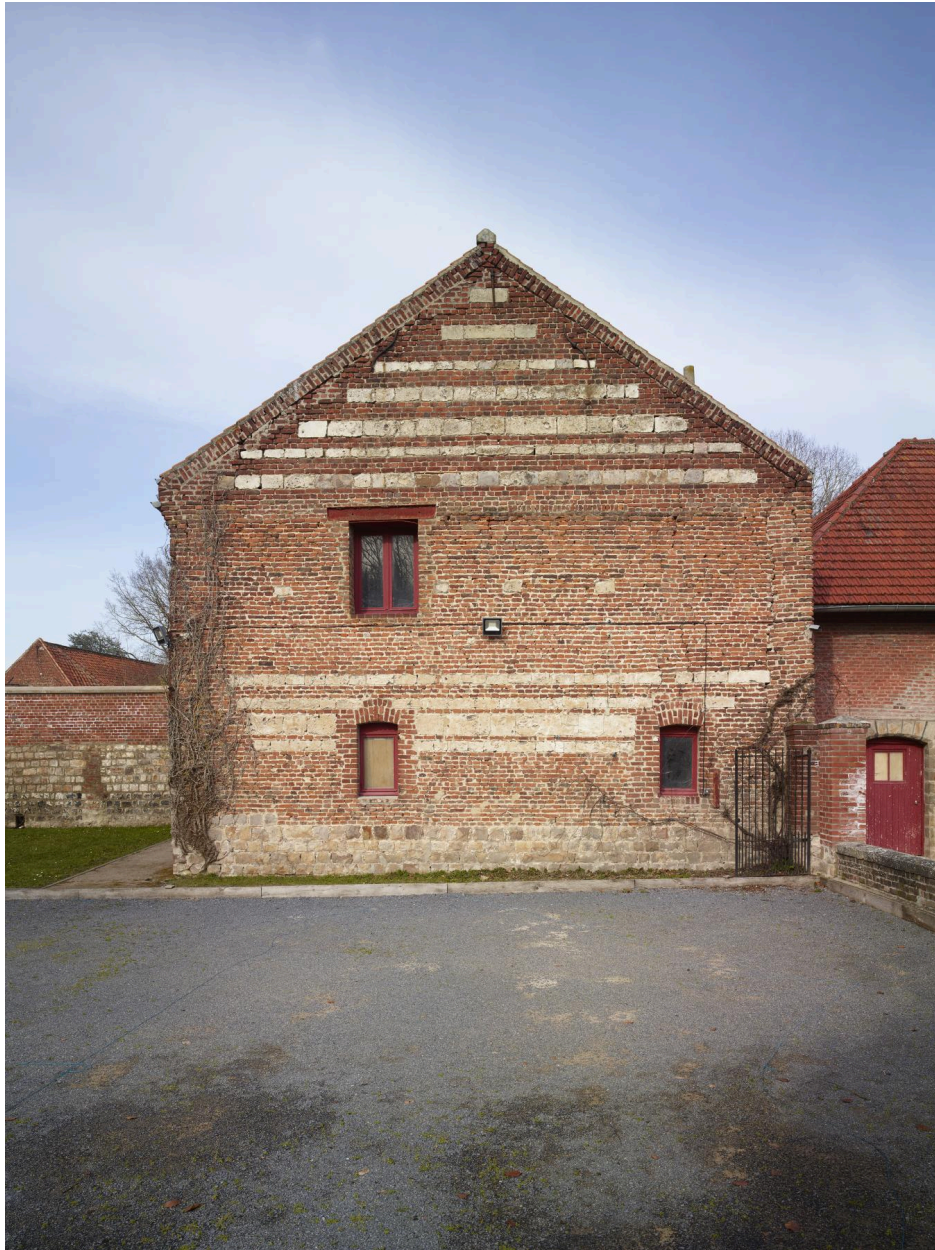
Mur pignon du bâtiment sud-ouest traité partiellement en rouges barres. Présence d'un linteau métallique.
