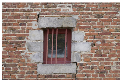
Détail de l'encadrement en grès d'une des ouvertures. Phot. Pierre Thibaut IVR32_20236200054NUCA
