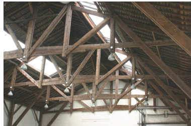
Charpente du hangar construit en fond de parcelle, rue Varlet. Phot. Frédéric Pillet IVR22_20050206089NUCA
