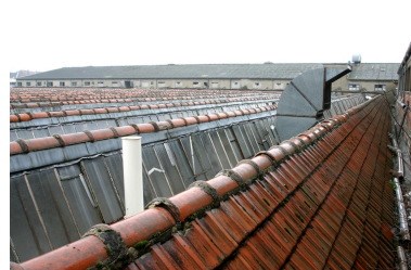
Les sheds des ateliers de 1921, vu en direction des ateliers de la rue Turbigo. Phot. Frédéric Pillet IVR22_20060205072NUCA
