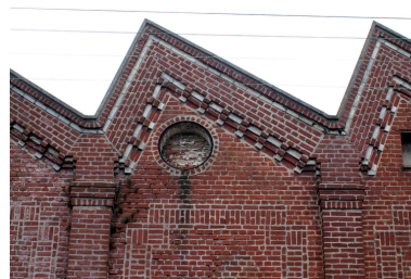
Détail de la façade de l'usine rue Turbigo : sheds. Phot. Frédéric Pillet IVR22_20060205066NUCA
