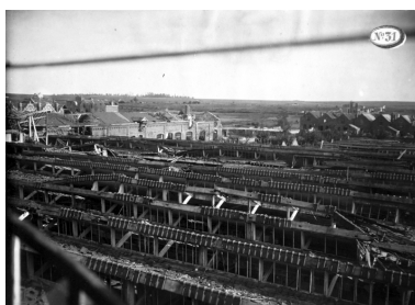
Vue générale des toits des ateliers en direction du sud-est, vers 1919 (AD Aisne). Phot. Pillet Frédéric IVR22_20050206489NUCAB
