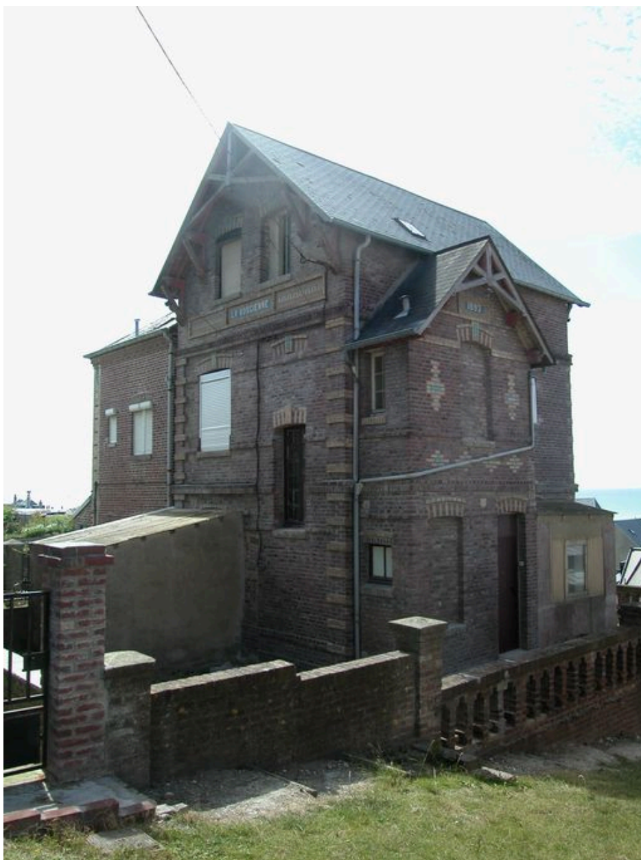
Vue de trois-quarts sur les élévations postérieure et latéral gauche, depuis la rue Dingleton.
