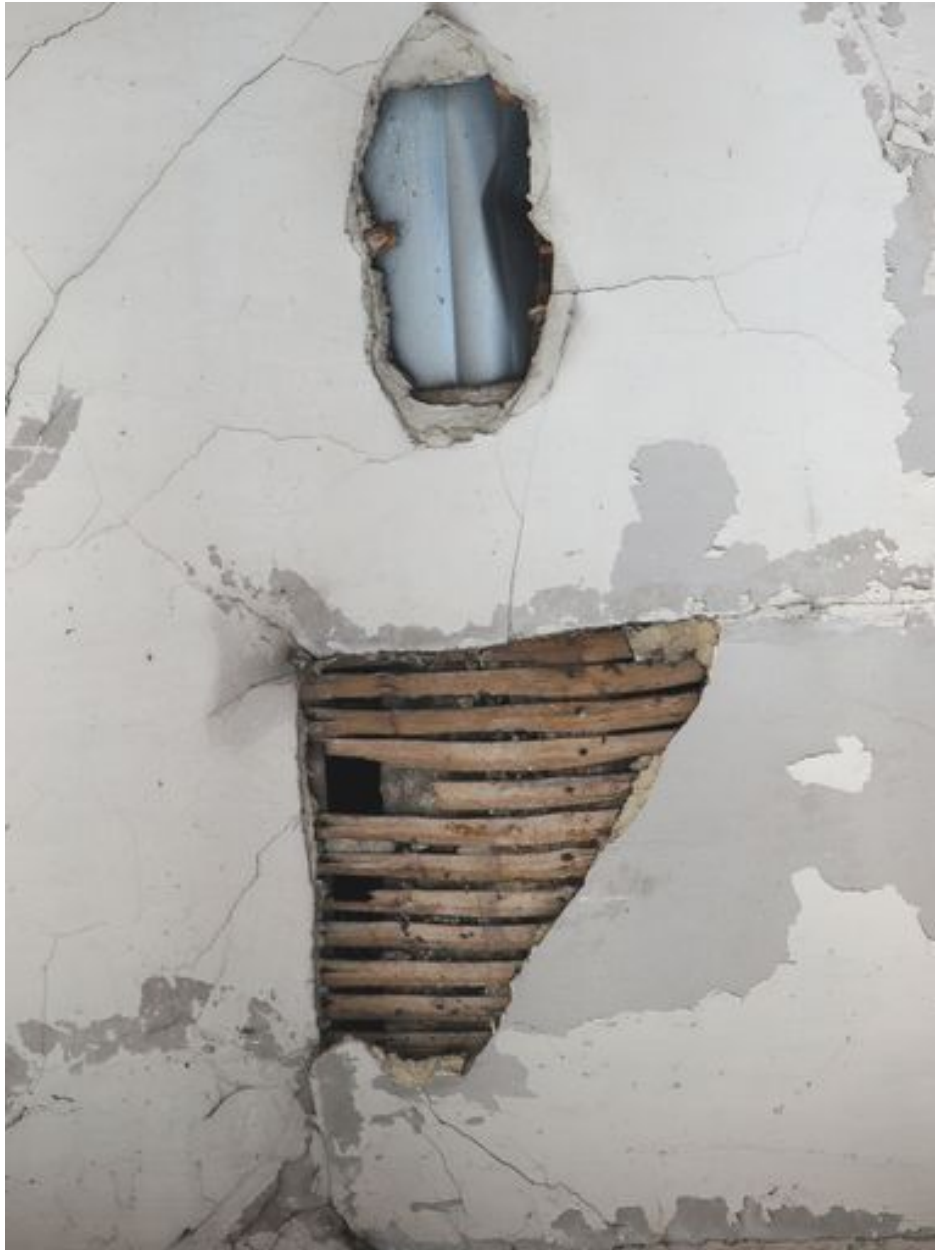
Désordres dans la voûte en plâtre sur lattis au niveau de la tribune d'orgue (partie sud)
