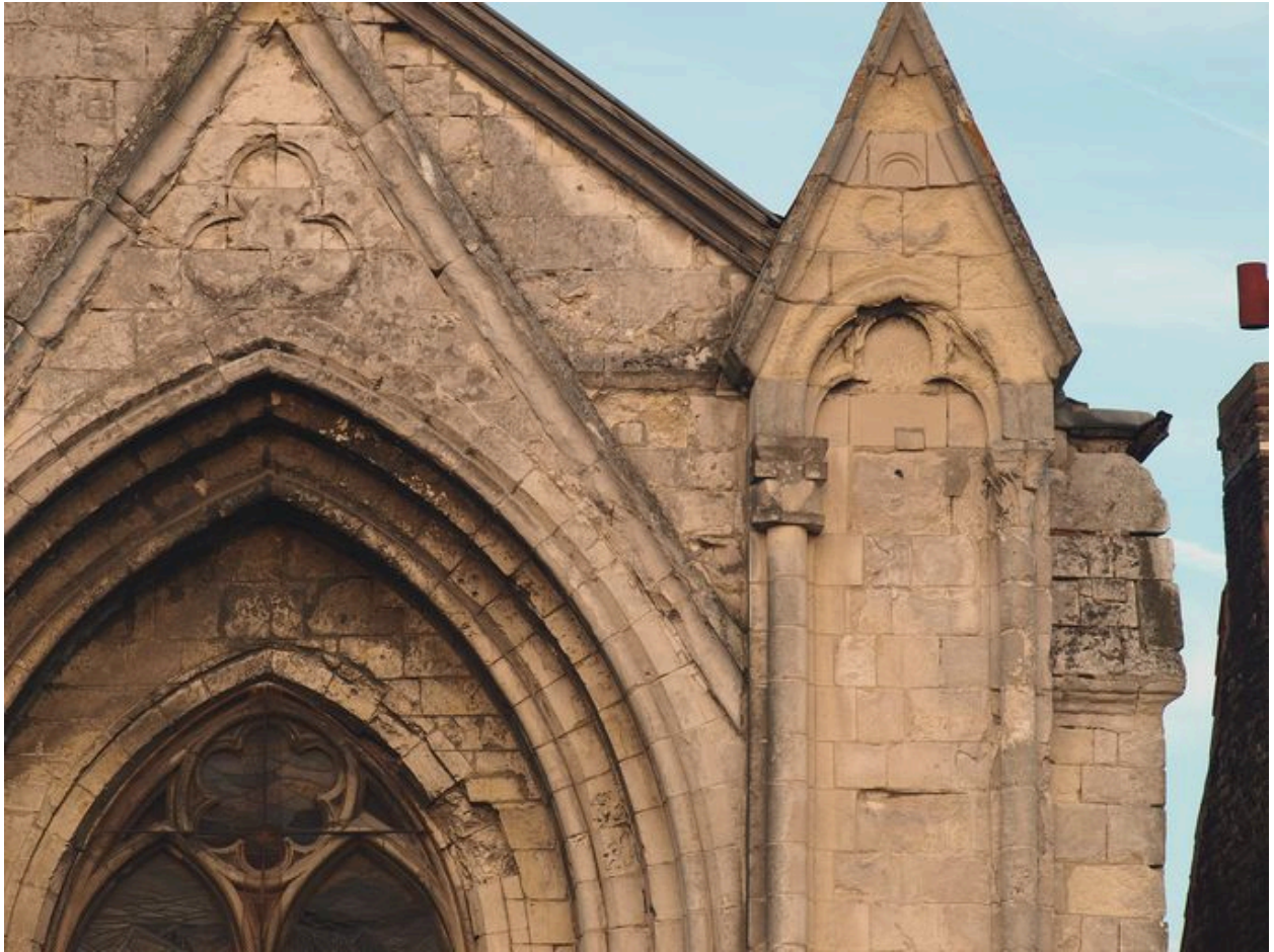
Gâble au-dessus de la fenêtre ouest du bas-côté sud et contrefort attenant : pierre érodée.
