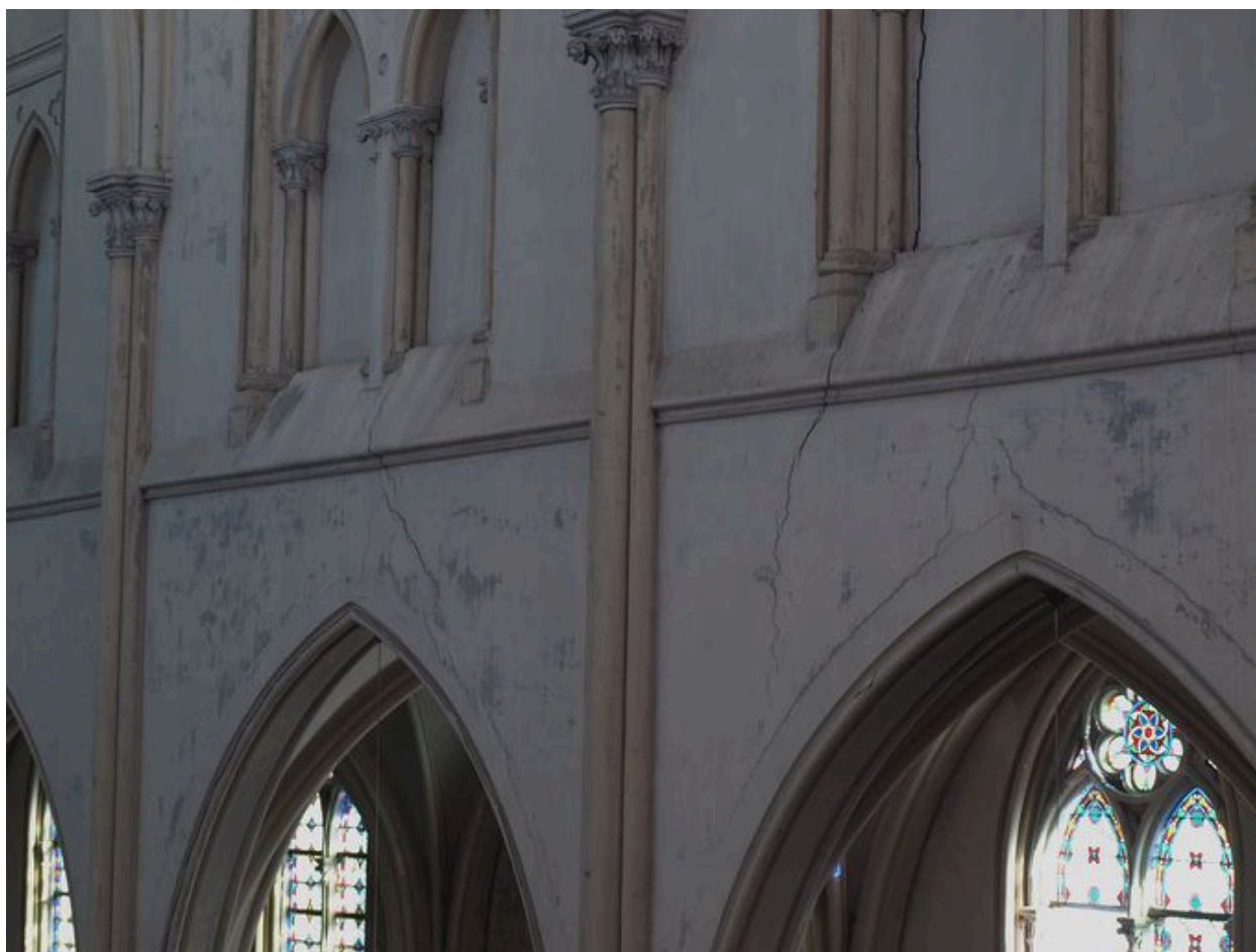
Haut des grandes arcades (mur sud de travées ouest) : fissures dans les écoinçons
