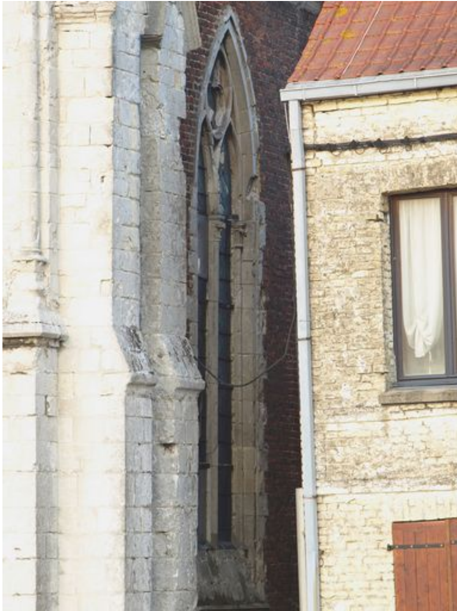
Fenêtre du bas-côté sud : mur en brique et encadrement en pierre calcaire
