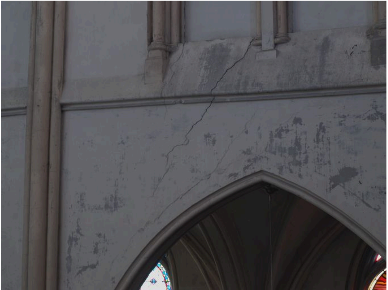
Haut d'une grande arcade (mur nord de travée ouest) : fissure en écoinçon
