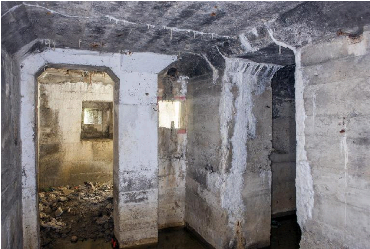
Depuis la salle ouest vers le couloir de distribution. Au centre le créneau de fusillade couvrant l'entrée
