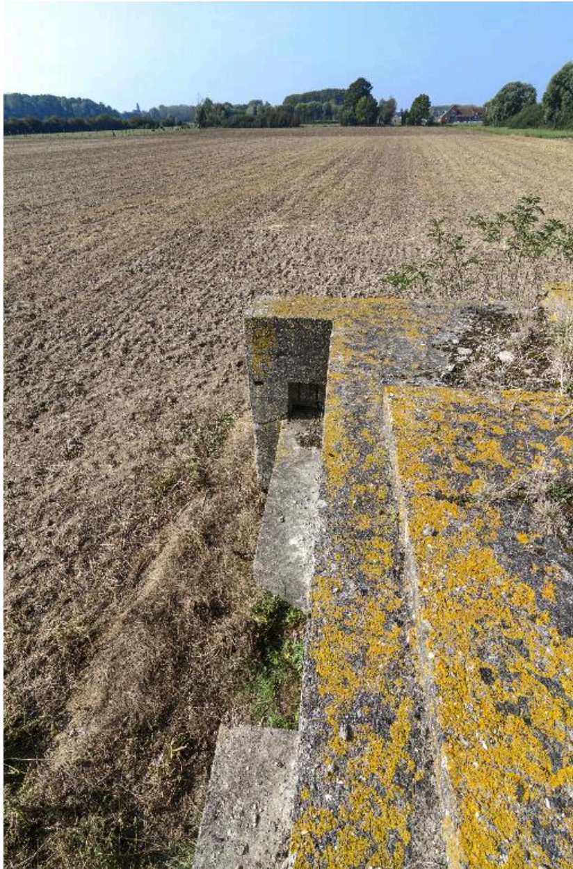
Depuis le couverture, banquette de tir et position de la mitrailleuse ouest
