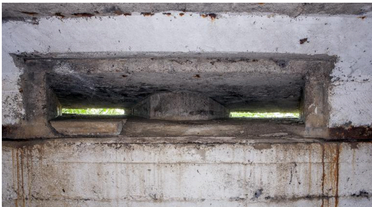
Salle est, détail du poste de surveillance.
