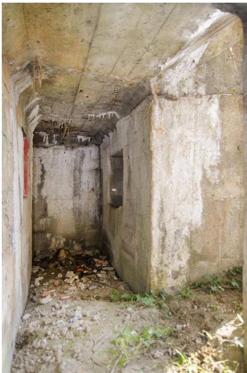
Couloir de distribution, vers l'est. A droite l'entrée et, au delà, le créneau de fusillade
