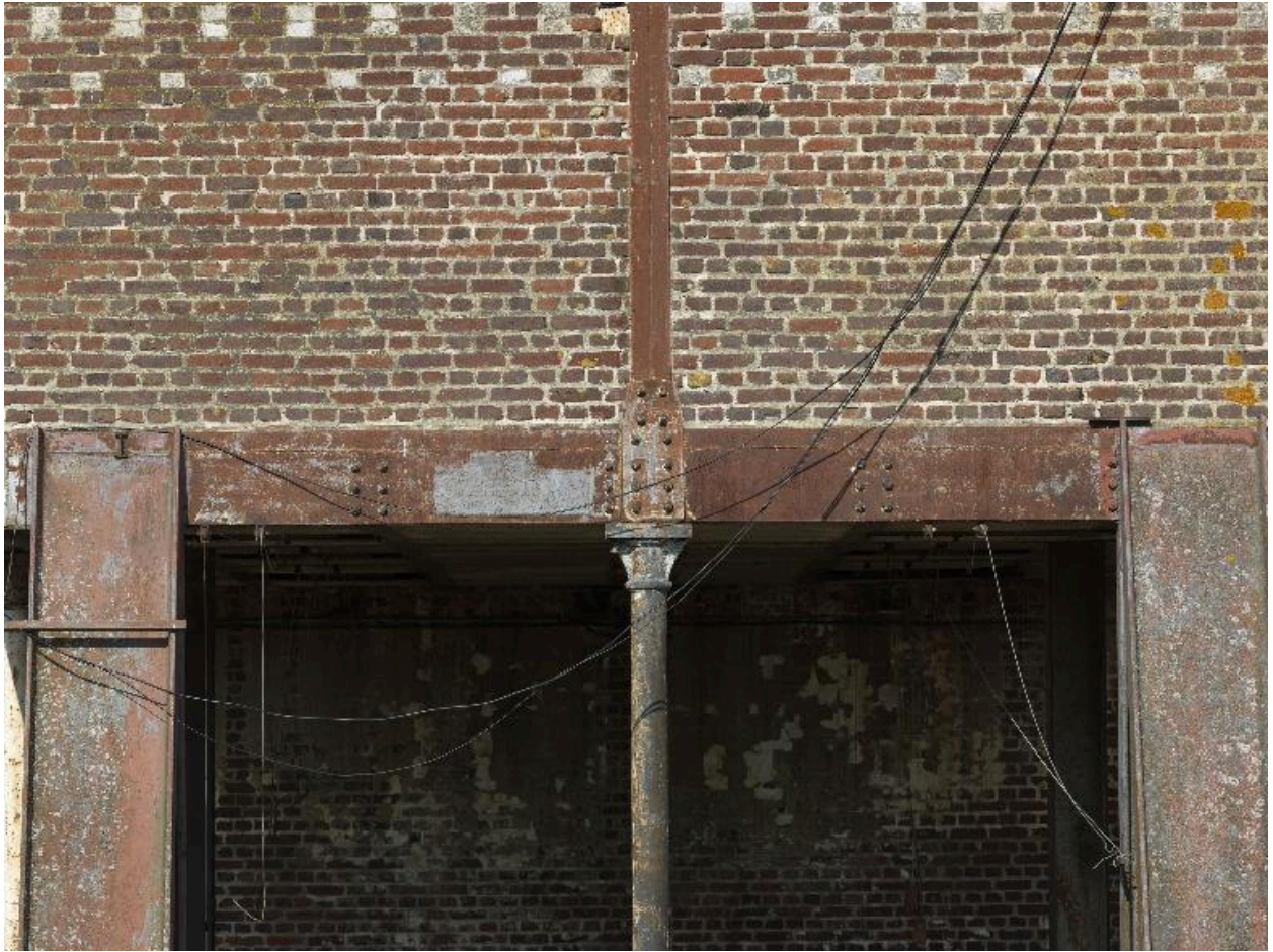
Détails d'une des colonnes en fonte supportant la structure métallique du bâtiment de production.
