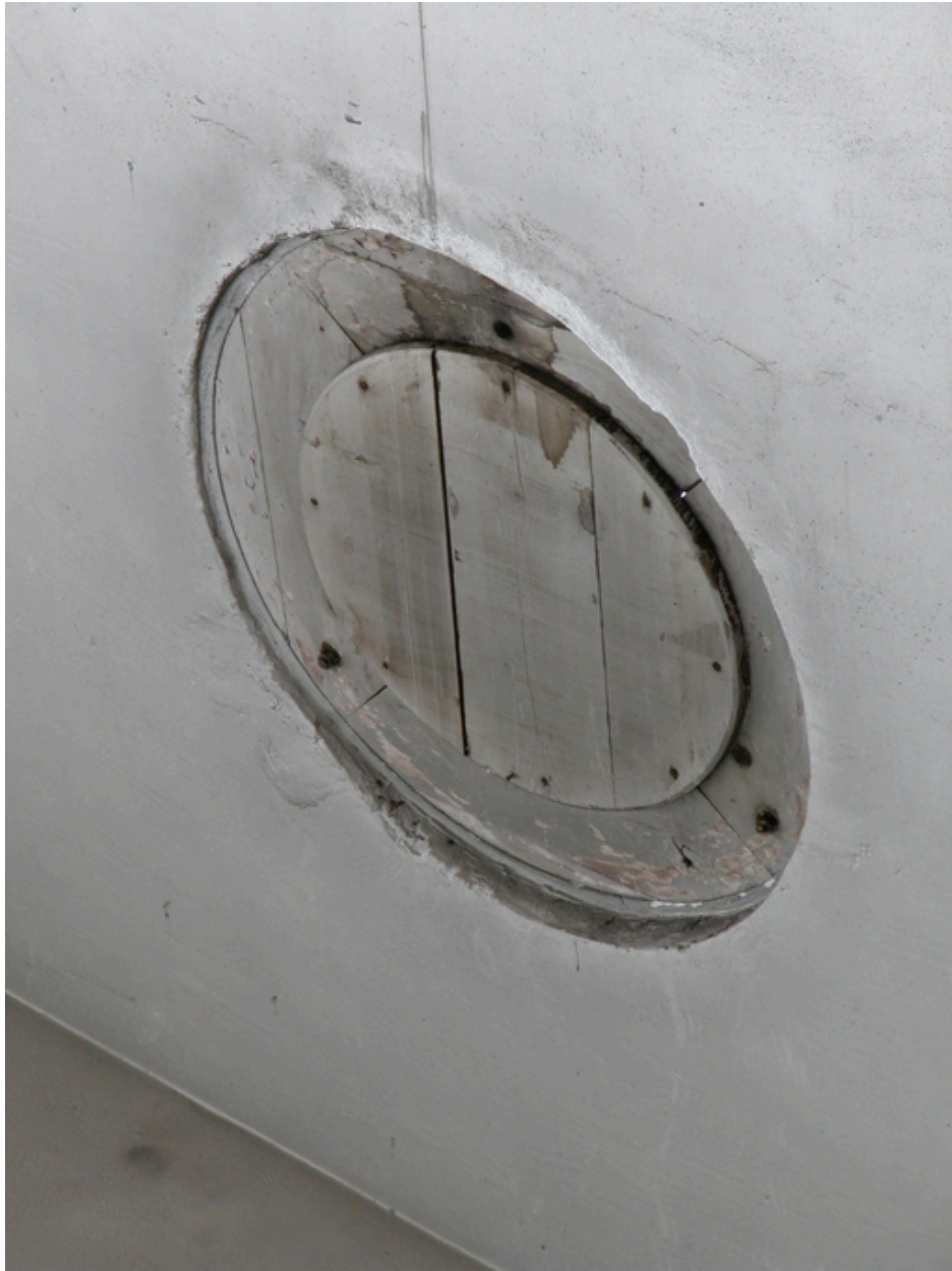
Oculus permettant la ventilation des ateliers de fabrication de la guipure (sous sheds) reconstruits après la Première Guerre mondiale.
