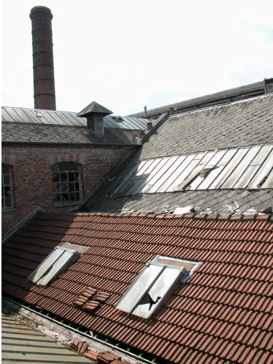
Le Cabinet de fabrication (à gauche), surplombant les ateliers de fabrication de la guipure.
