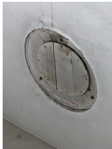
Oculus permettant la ventilation des ateliers de fabrication de la guipure (sous sheds) reconstruits après la Première Guerre mondiale.
