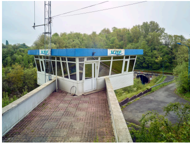
Tête nord : entrée du poste de commande directement dans la passerelle de contrôle. Phot. Pierre Thibaut IVR32_20216200767NUCA
