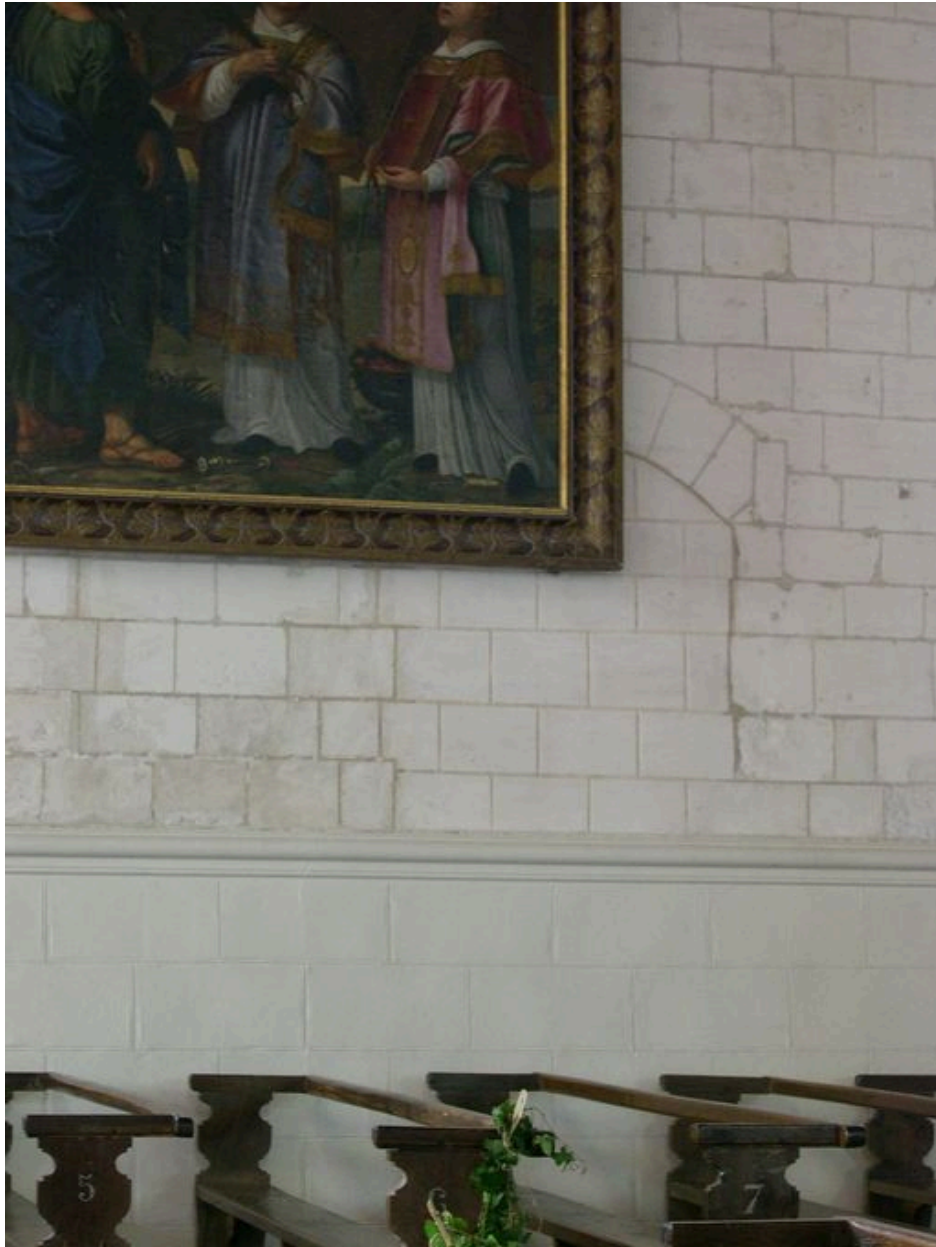
Trace de baie murée dans le mur sud de la nef.
