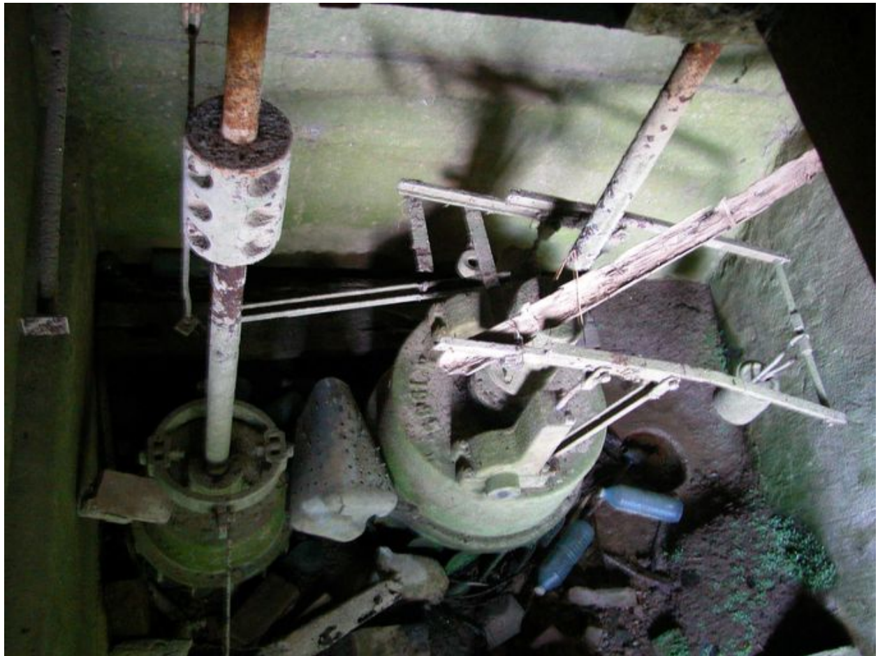
Vue de dessus des deux turbines.
