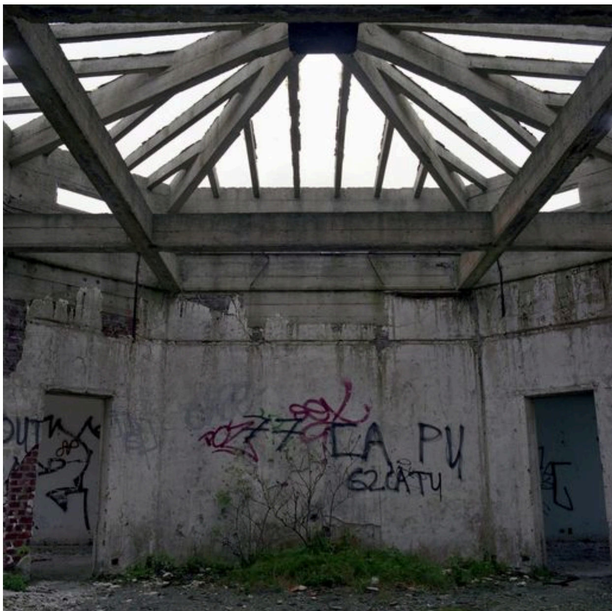
Aile devant renfermer les services médico-techniques, située sur l'arrière du bâtiment d'hospitalisation, couverture de la salle d'opération, vue prise de l'intérieur de la salle.
