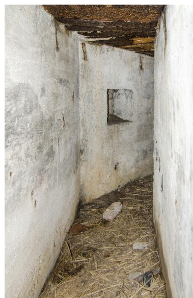
Vue intérieure (au grand angle et vers la salle) de la coursière de tir flanquant l'entrée ouest. Phot. Jean-Marc Ramette IVR32_20165901130NUCA
