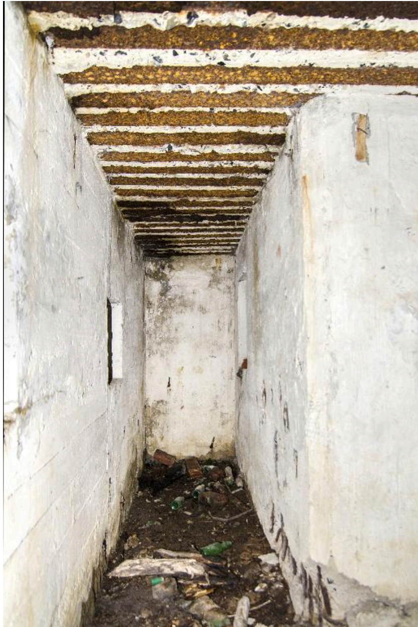
Vue intérieure (au grand angle) de la coursière de tir flanquant l'entrée est.
