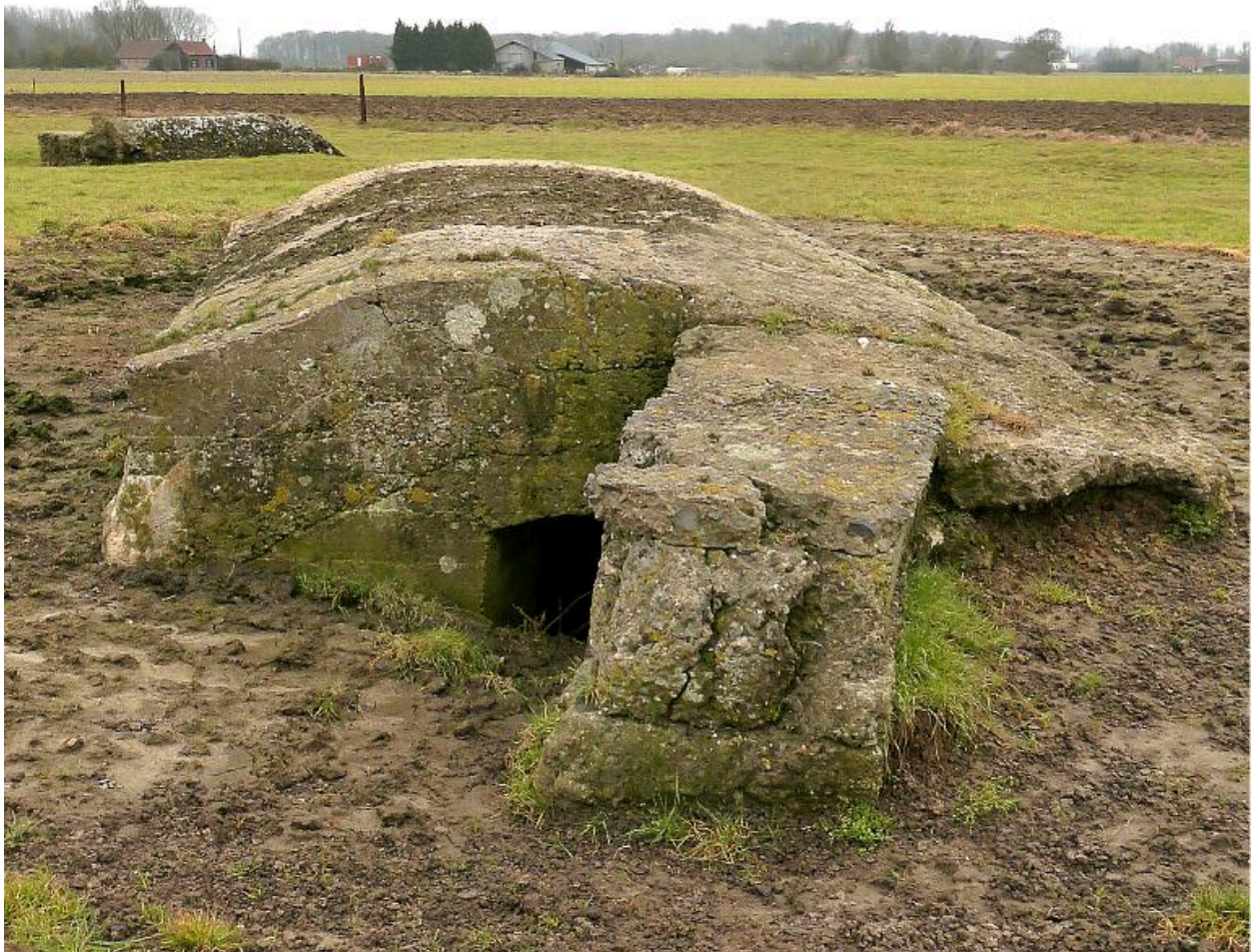
Vue des deux casemates, vers le sud. Au premier plan, l'entrée nord et son mur pare-souffle
