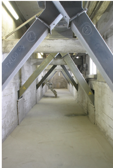
Systèmes de distribution des cellules du silo à blé. Phot. Frédéric Pillet IVR22_20050205187NUCA
