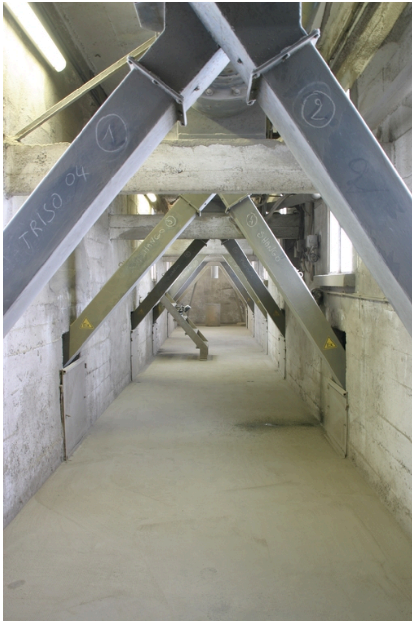
Systèmes de distribution des cellules du silo à blé.
