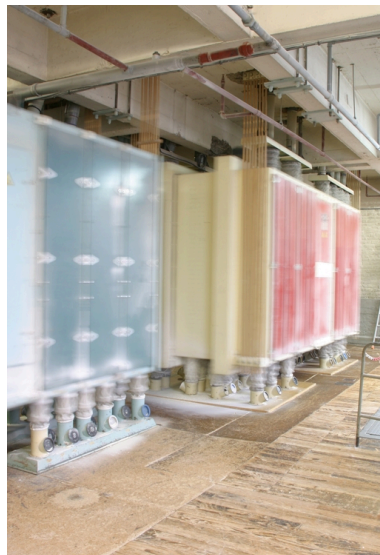
Quatrième étage de la minoterie : plansichters. Phot. Frédéric Pillet IVR22_20050205182NUCA
