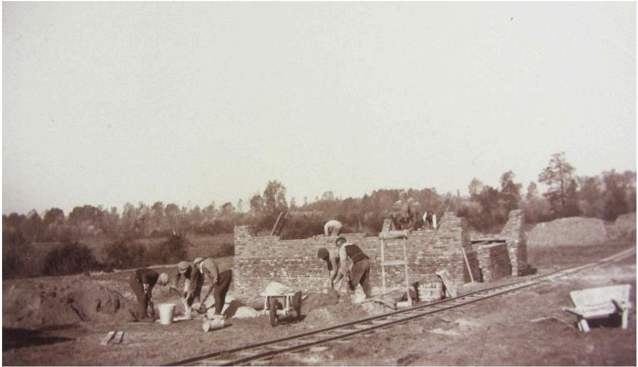
Edification des murs d'une des maisons de contremaître, 27 octobre 1920 (AD Somme ; 49 Fi 74).
