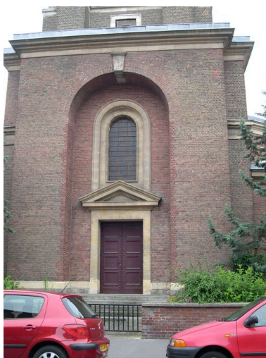
Vue de détail : baie est de la tour de clocher. Phot. Isabelle Barbedor IVR22_20068010110NUCA
