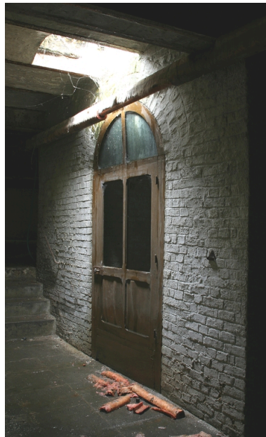
Ancienne chaufferie de l'usine : petite pièce voûtée en cul-de-four (ancien puits ?). Phot. Frédéric Pillet IVR22_20050205561NUCA
