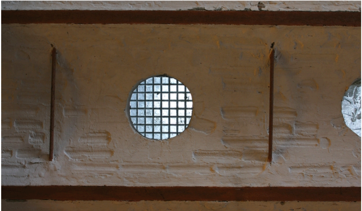
Voûtain du plancher des combles de l'atelier de 1900, percé pour l'éclairage du rez-de-chaussée.
