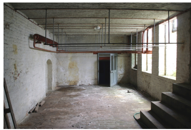
Sous-sol des ateliers de 1870-1880 : ancien atelier de mécanique en 1914. Phot. Frédéric Pillet IVR22_20050205549NUCA
