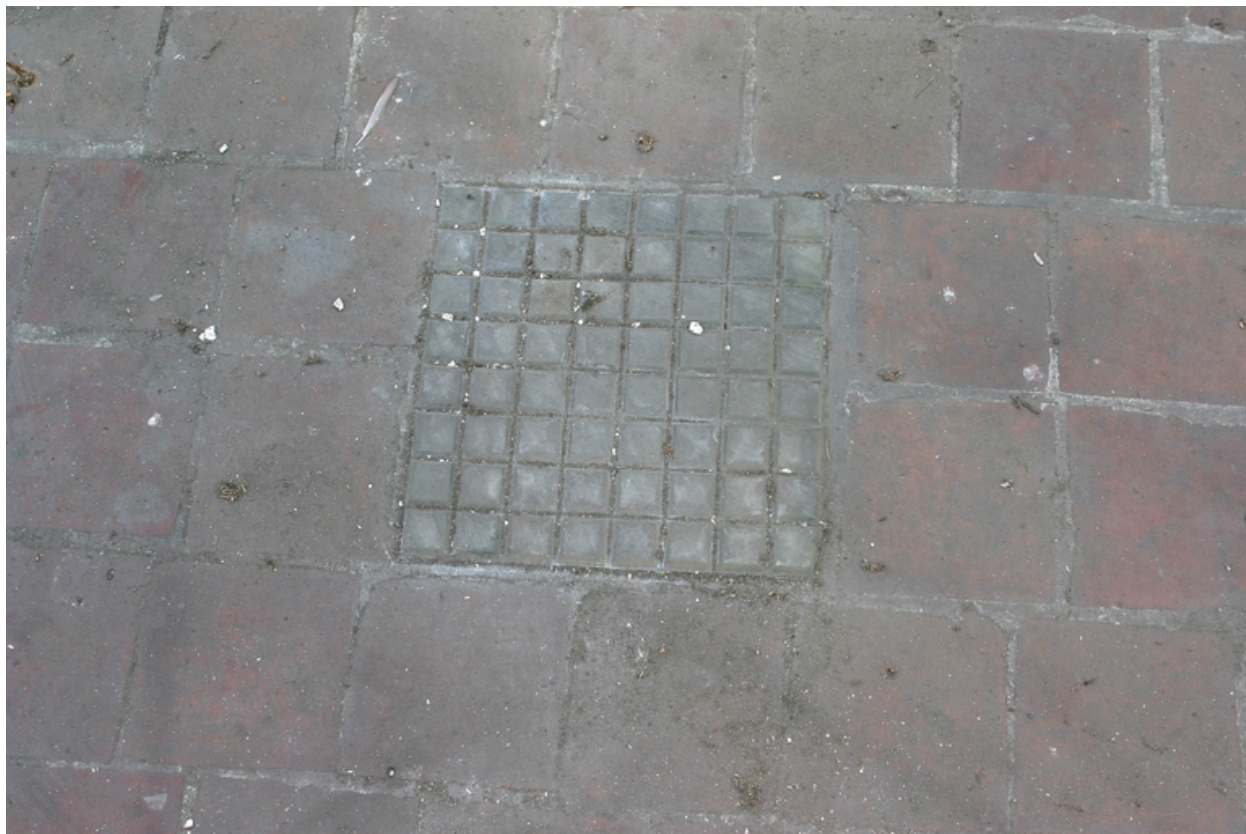
Pavé de verre du plancher des combles de l'atelier de 1900, pour l'éclairage du rez-de-chaussée.
