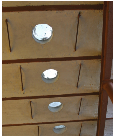
Voûtains du plancher des combles de l'atelier de 1900, percés de pavés de verre pour l'éclairage du rez-de-chaussée.
